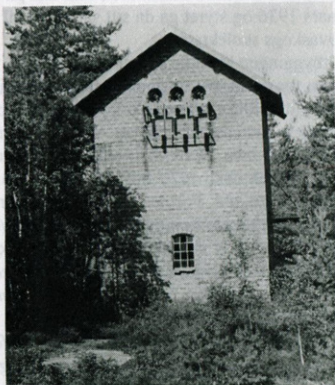
Transformatorkiosken ved Bergli, Ise tatt i bruk 1.11.1922. Den ble bygd av murermeister Johansen. Installasjonen var ved Ole E. og Einar E. Berby. (Østfold fylkes billedarkiv)
