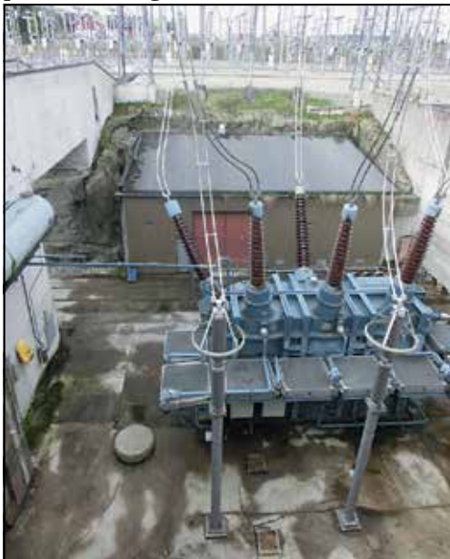
Transformatoren «T6», et begrep innen norsk kraftoverføringsmiljø. Den eneste av de opprinnelige transformatorene som er igjen på Hasle. Fotograf: Øistein Bøe
